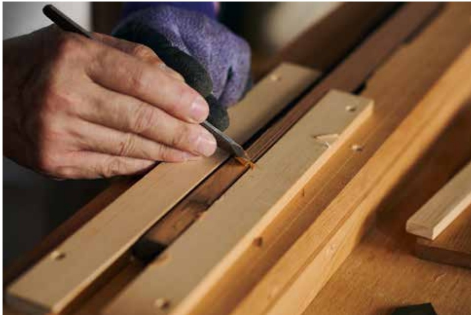
木目ひとつひとつを剥がすように損傷部分を削り取る
